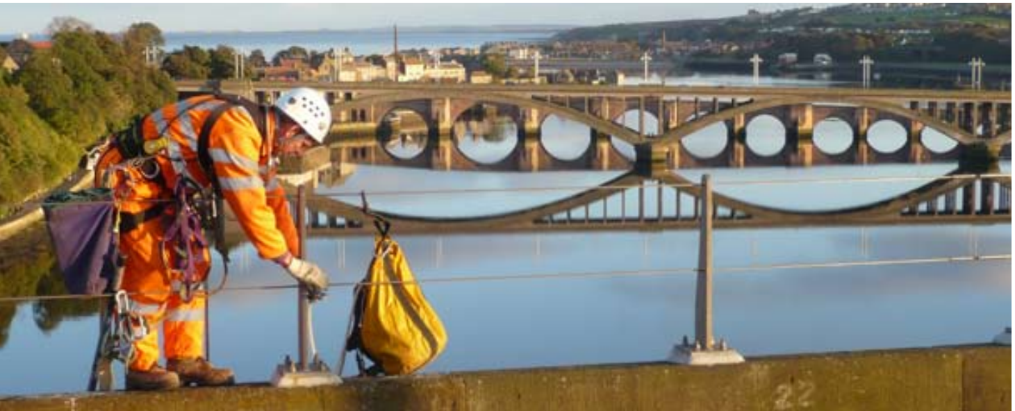
Un operario de Amey trabaja sobre el Royal Bridge (Berwick Upon Tweed, Reino Unido).
