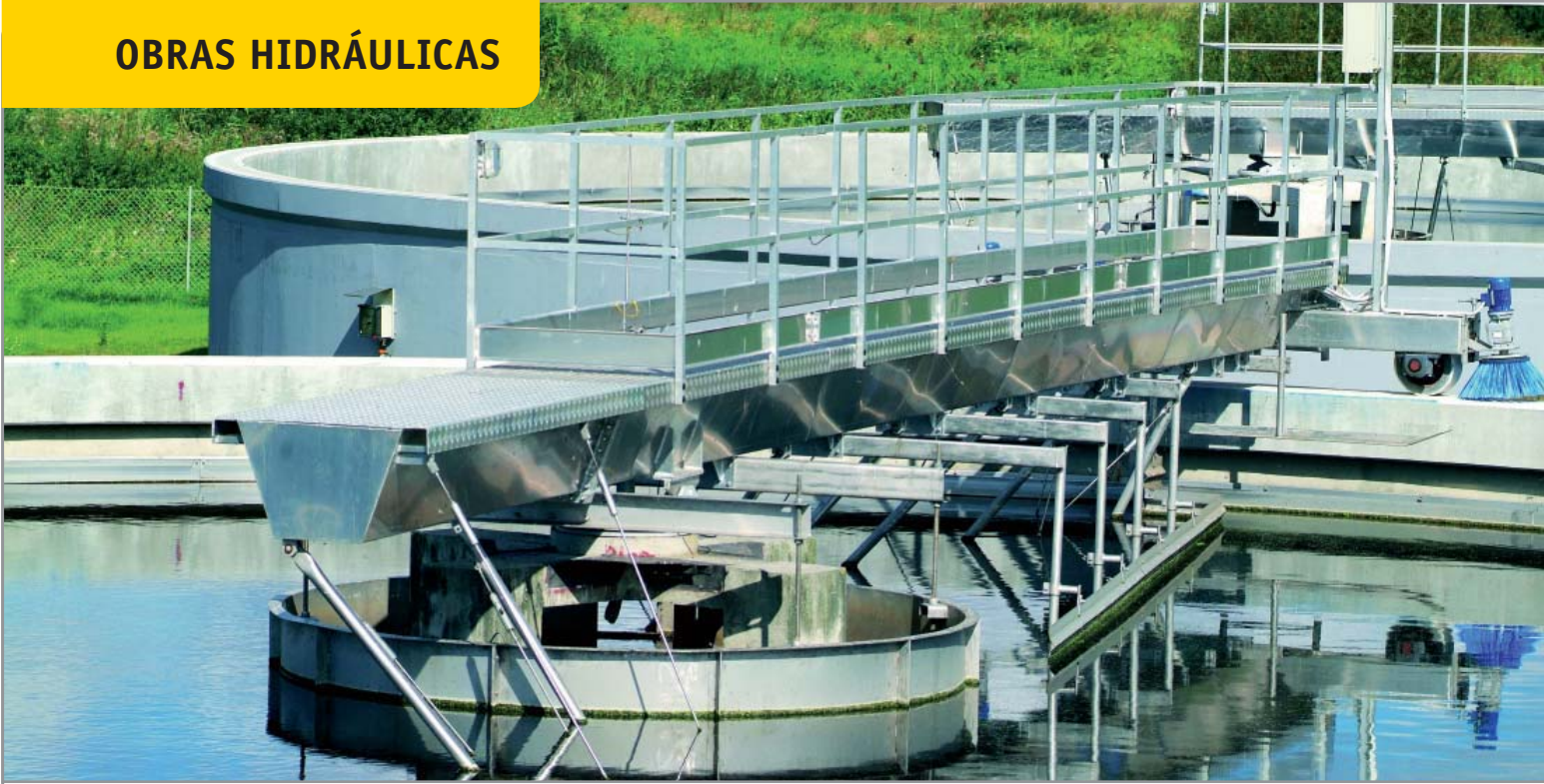
Estación depuradora de aguas residuales (EDAR) en Gryfino (Polonia)
