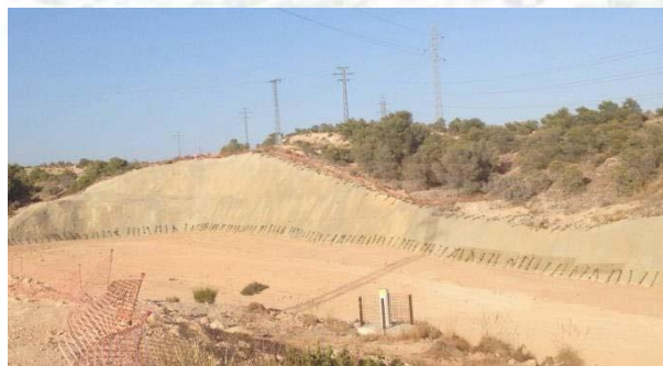
Aspecto de los taludes pendientes de ser restaurados
